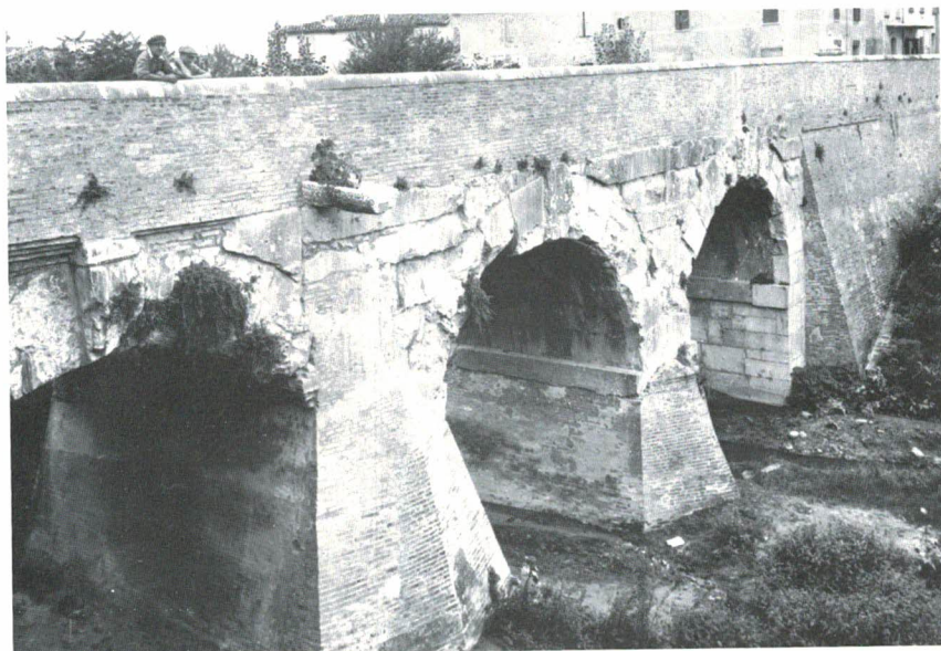
Fig. 2. SAVIGNANO SUL RUBICONE, lato a valle del ponte romano (prima del crollo).
