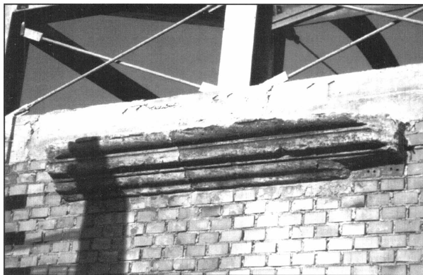
Fig. 3. Porzione di gronda ritrovata fra il materiale giacente a terra
